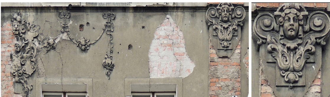
Zachowany fragment dekoracji w osi środkowej elewacji i głowica pilastra
