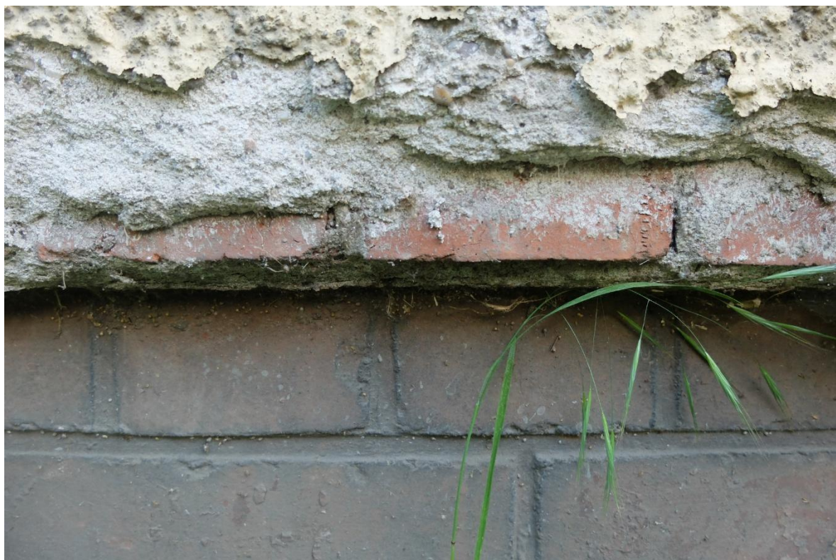
FOT. 6 – detal fot. 5 – nawarstwienia tynku nad cokołem licowanym cegłą ceramiczną czerwoną.
