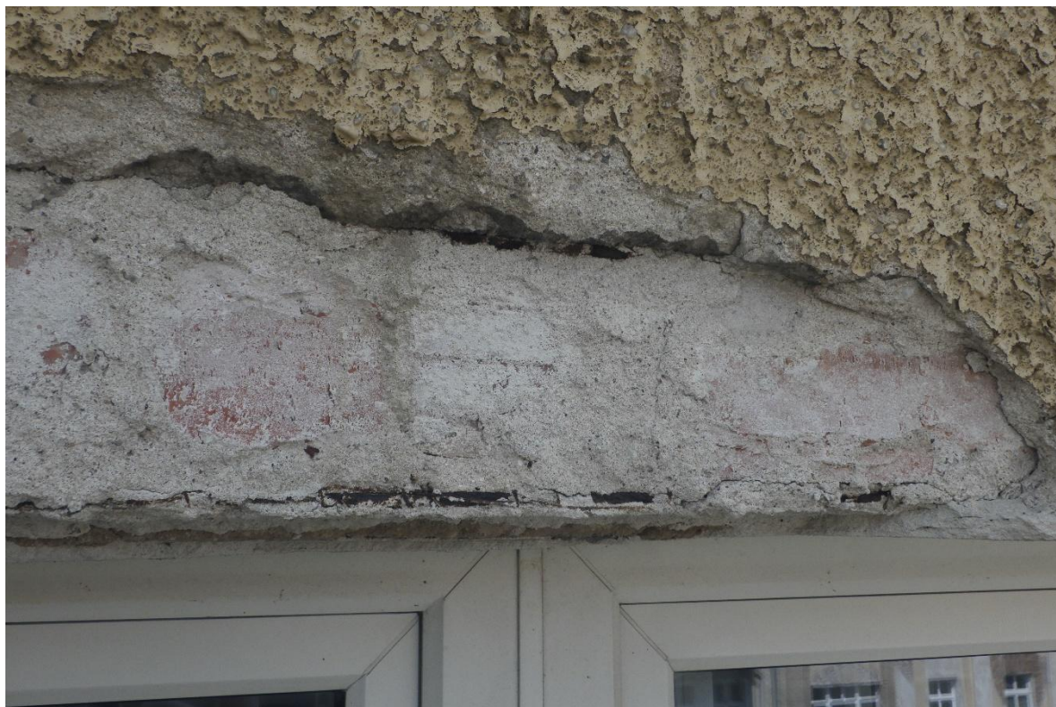
FOT. 12 - Elewacja frontowa, IV kondygnacja stalowa belka w nadprożu okna , pęknięcie na granicy materiałów.
