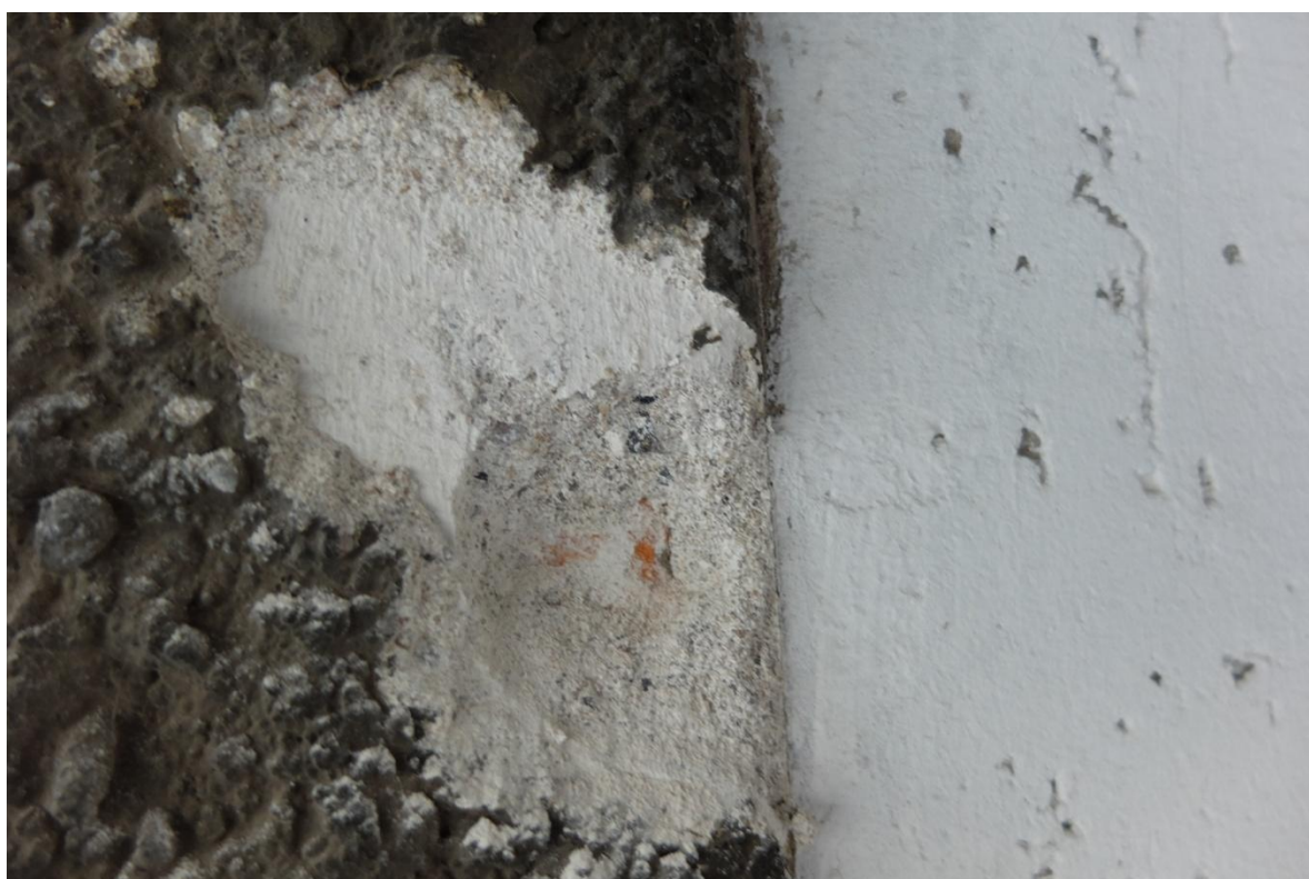
FOT. 13, 14 – Elewacja frontowa, brama przejazdowa oryginalny tynk wapienny warstwowy w miejscu pobrania próbki nr 4, obok fragment powierzchni ściany pokrytej arkuszami styropianu i tynku cienkowarstwowego.
