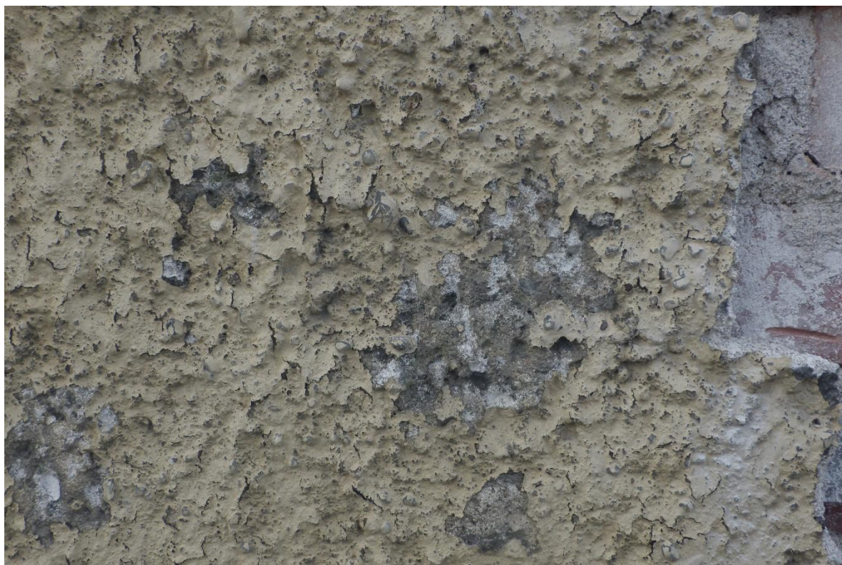
FOT. 9, 10 - Elewacja frontowa, fragmenty powierzchni – nawarstwienia remontowe na zabrudzonej powierzchni cegły licowej oraz białego tynku wapiennego spoiny i fakturowanej powierzchni elewacji.
