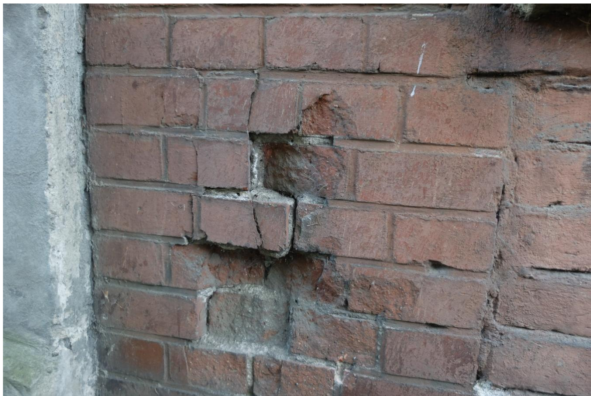
FOT. 7 - Elewacja frontowa, oś skrajna wschodnia – ceglane lico obramienia przy zaślepionej obecnie witrynie sklepu, fragment – spękanie cegieł, ubytki.
