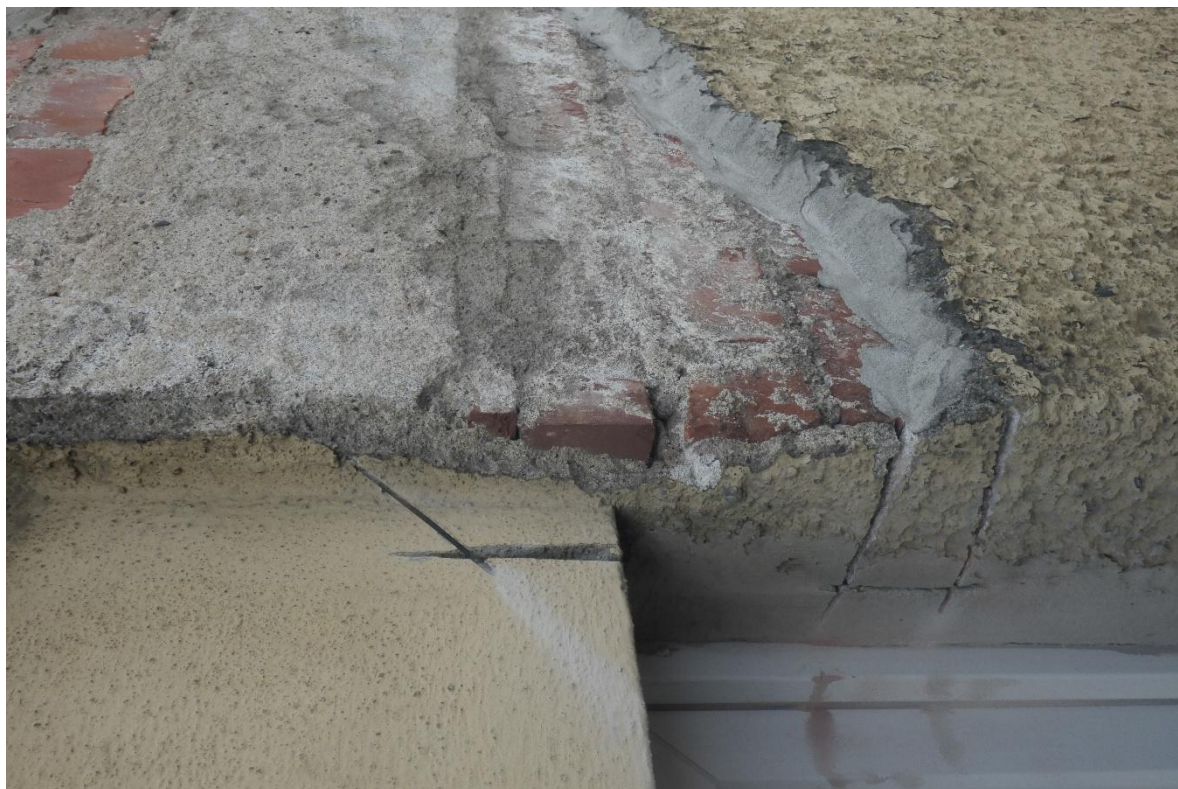
FOT. 11 - Elewacja frontowa, IV kondygnacja, fragment – belka między oknami klatki schodowej i ściana elewacji w miejscu pobrania próbek 2, 3. W miejscu ubytku widoczna żelbetowa belka konstrukcji.
