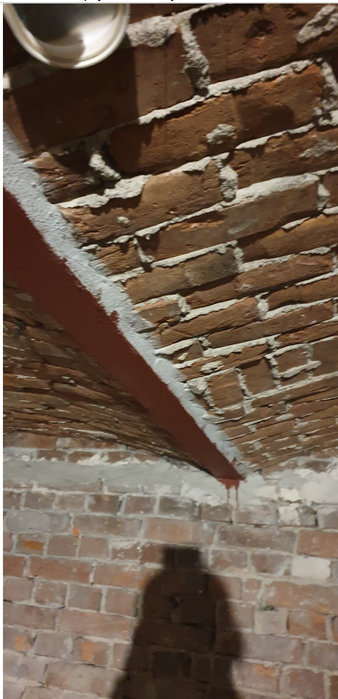
Fot. 7: Naprawiona wcześniej belka stropowa
