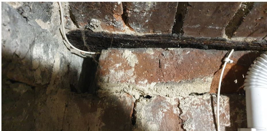
Fot. 10: Mocno skorodowana belka stalowa
