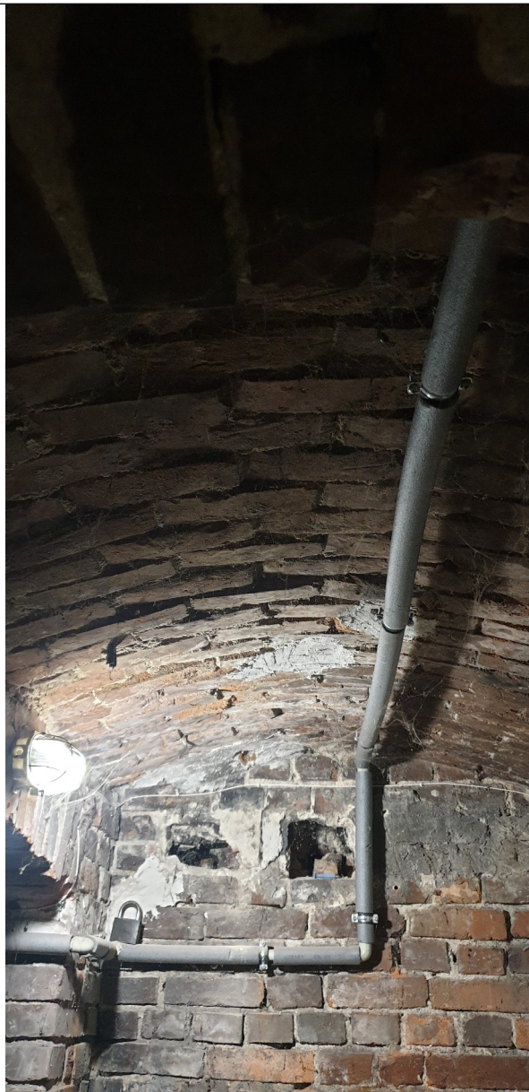
Fot. 9: Sklepienie odcinkowe – widoczne braki wypełnienia spoin
