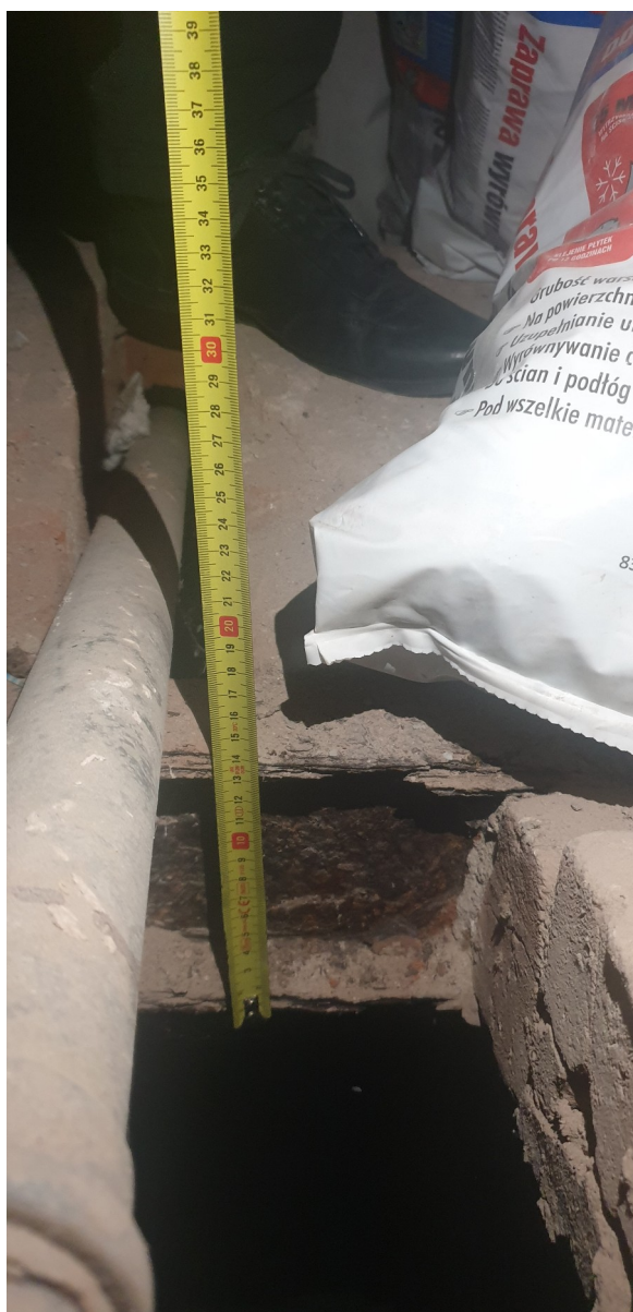
Fot. 8: Belka I140 stropu nad piwnicą – widoczne znaczne ślady korozji
